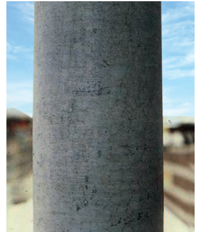
Bild 10-1. Exponerad yta av en zinkbeläggning med ett yttre skikt av ren zink. Den blanka ytan försvinner och ersätts av grå korrosionsprodukter – ibland kallat zinkpatina.
