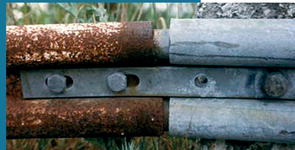
Bild 1-2. Till vänster i bild målat vägräcke som korroderat. Jämför med det varmforzinkade räcket till höger.
