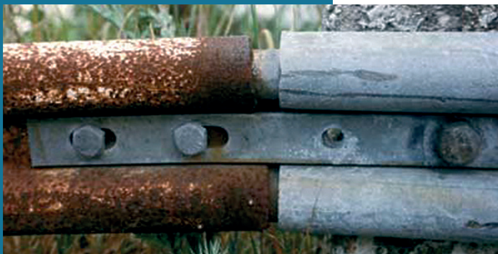
Billede 1-2. Korrosion på malet autoværn, sammenlignet med varmforzinket værn.
