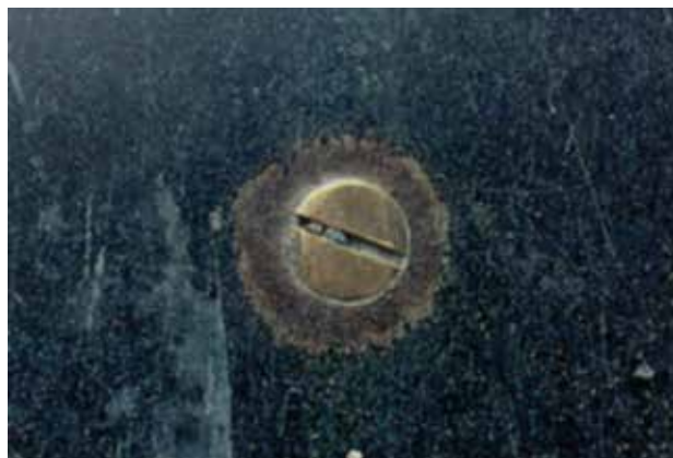
Billede 10-13. Messingskrue i varmforzinket plade angriber zinken.
