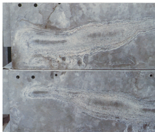
Bild 45. Varmförzinkad yta angripen av vitrost.
