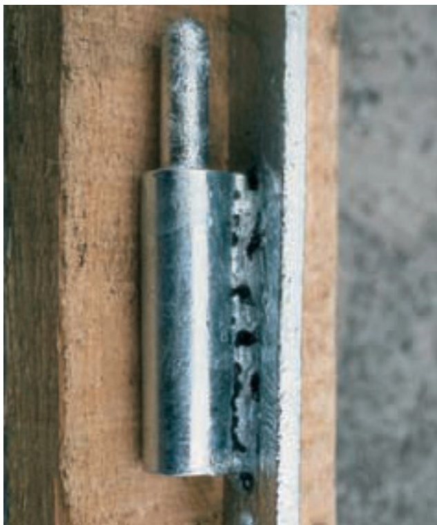
En hyppigt forekommende fejl på varmforzinkede emner. Mangelfuld afrensning af svejseslagge før varmforzinkning.
