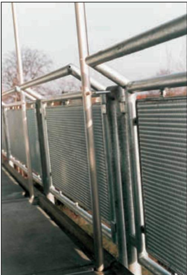
Varmforzinkede altanrækværker i højhusbyggeri.
