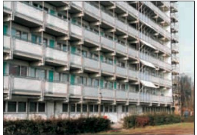
Varmforzinkede altanrækværker i højhusbyggeri.
